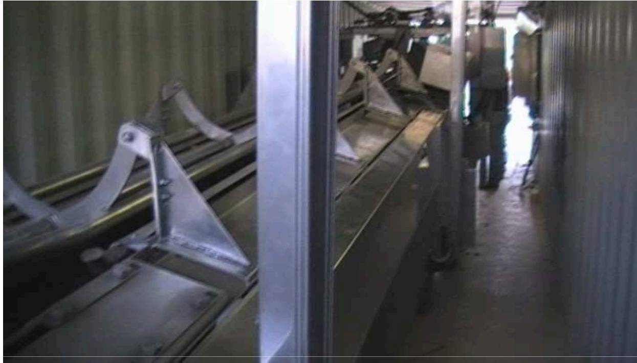
Vista interna (da lato alimentazione) del RE-MO
